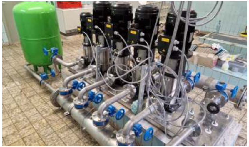
Die neu eingebaute Pumpengruppe
