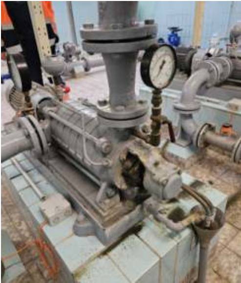
So sahen die Pumpen im Wasserhaus aus dem Jahr 1965 aus. Diese sind zwischenzeitlich ausgebaut und wurden verschrottet.
