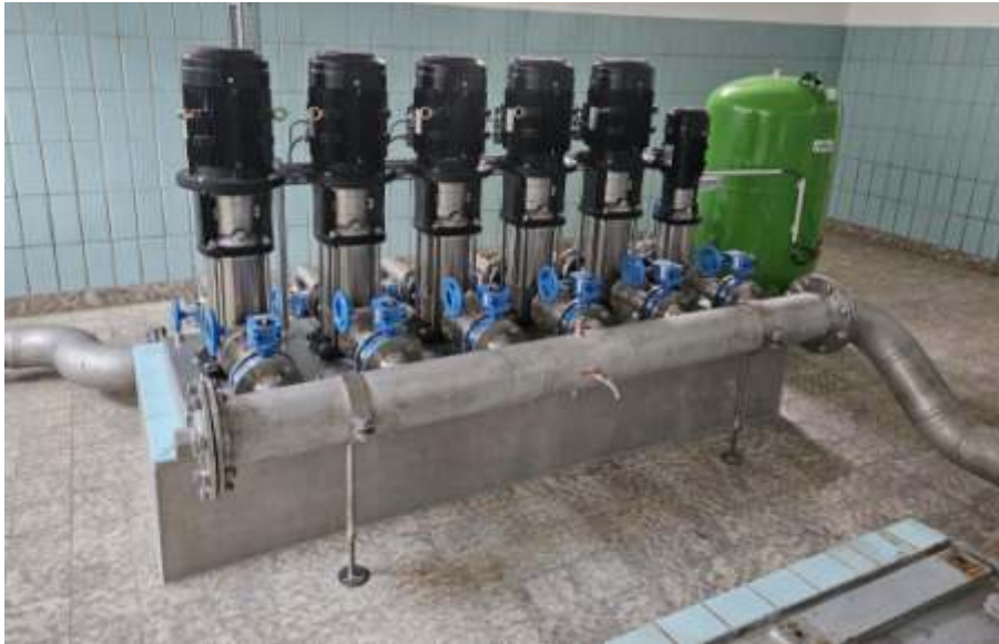
Die neue Pumpeneinheit. Ob diese auch so lange halten wie die alten Pumpen? Diese verrichteten ihren Dienst 60 Jahre lang (das war noch deutsche Wertarbeit).
